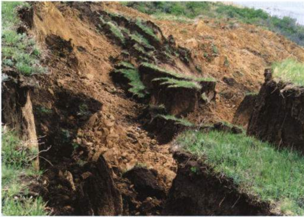
Рис. 8. Оползень на северном берегу Таманского п-ва
